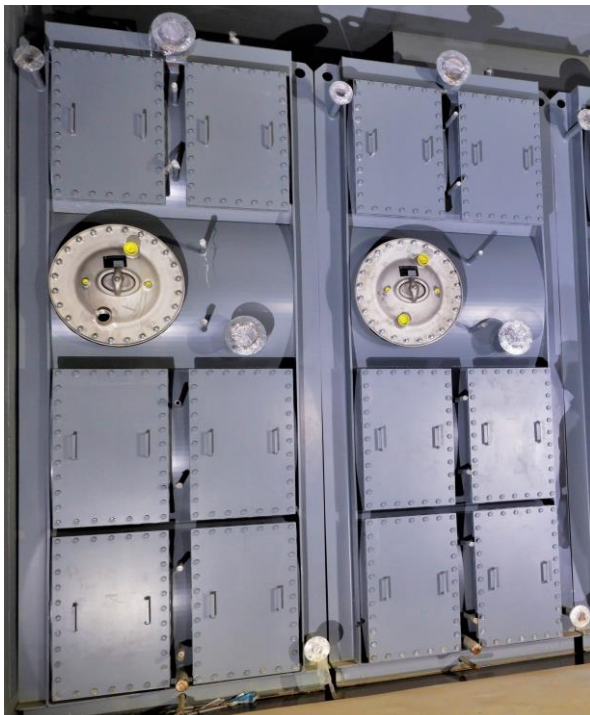
Schichtspeicher 200K mit Thermalwasserwärmetauscher
